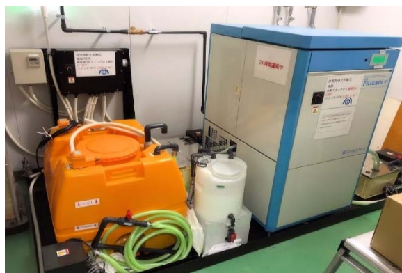
水溶性排水処理装置
